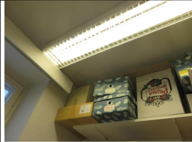
Kuva 1. Tilan 63 kosteusvaurio varaston katossa.
