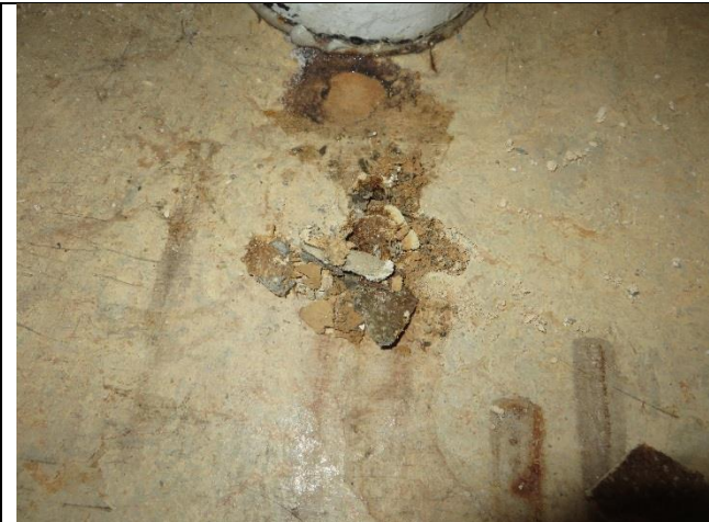
Kuva 3. Tilan 15, kellarin lattian kosteusvaurio.
