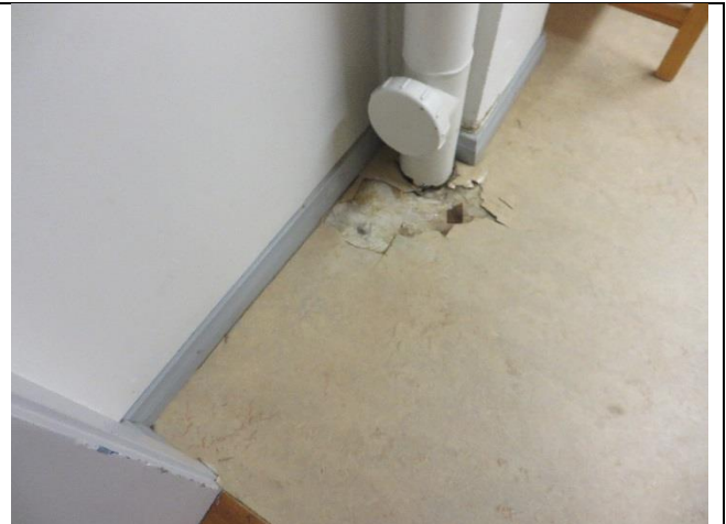
Kuva 4. Tilan 20 kosteusvaurio lattiassa.
