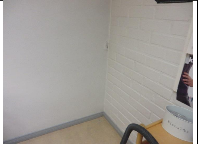
Kuva 2. Tilan 20 kosteusvaurio seinässä.
