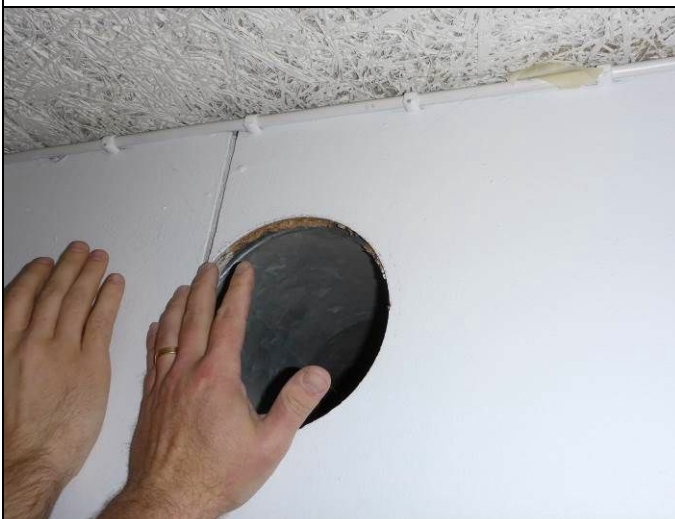
Kuva 43. Poistoilmakanavan päästä puuttuu säätöventtiili, poistoilmavirtaus oli tutkimushetkellä normaali
