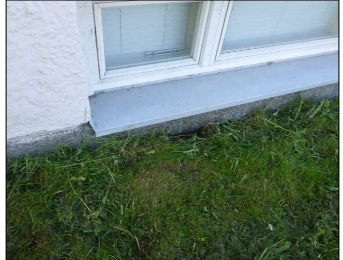
Kuva 6. Nurmipinta ulottuu rakennuksen viereen. Multamaa aiheuttaa ylimääräistä kosteusrasitusta sokkelipintaan.
