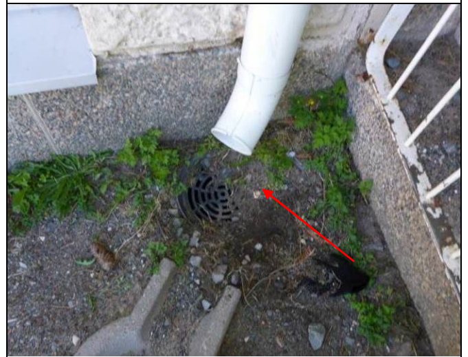
Kuva 4. Syöksytorven ulosheittäjä on väärin suunnattu ja vesi ei kulkeudu suoraan kaivoon. Vesi on kuljettanut sadevesikaivon päälle maa-ainesta, joka estää veden virtauksen kaivoon ja tukkeuttaa sadevesijärjestelmää
