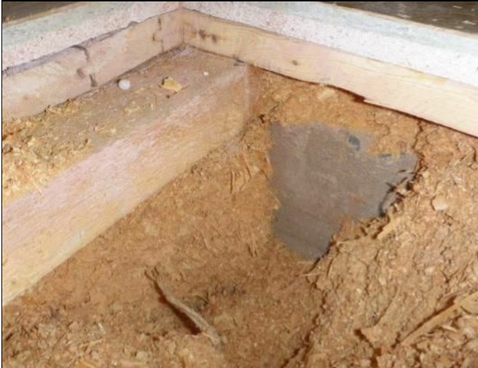
Kuva 24. Tilan 005 välipohjan rakenneavaus (VP1). Sahanpurueristeestä havaittiin mikrobivaurioindikaattori Aspergillus Versicolor .
