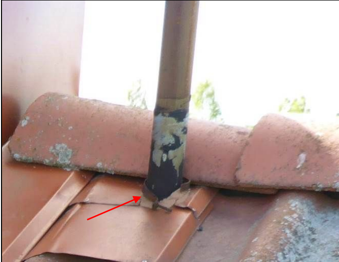
Kuva 38. Tuuletusputken läpivienti ei ole tiivis. Sadevesi voi tunkeutua katto - ja yläpohjarakenteisiin
