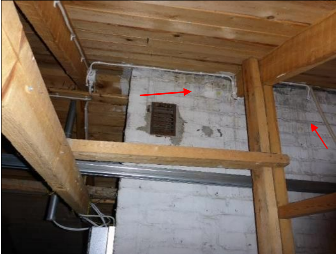
Kuva 34. Savupiipun läpivienti on vuotanut. Savupiipun läpivienti ei ole tiivis, joten vesikatolla valuva vesi voi siirtyä yläpohjaan
