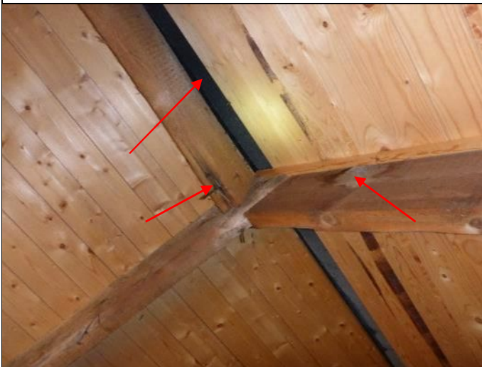
Kuva 30. Vanhan osan harjalla on vuotojälkiä. Umpilaudoituksen päällä on mattohuopa, joka näyttää olevan limitetty harjan yli
