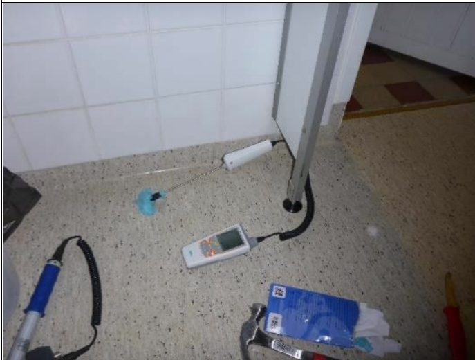
Kuva 12. Kellarin wc- ja suihkutilojen lattiämateriaalina on käytetty muovimattoa. Naisten henkilökunnan wc:stä (tila 005) havaittiin korkea suhteellinen kosteus lattiämattom alla.
