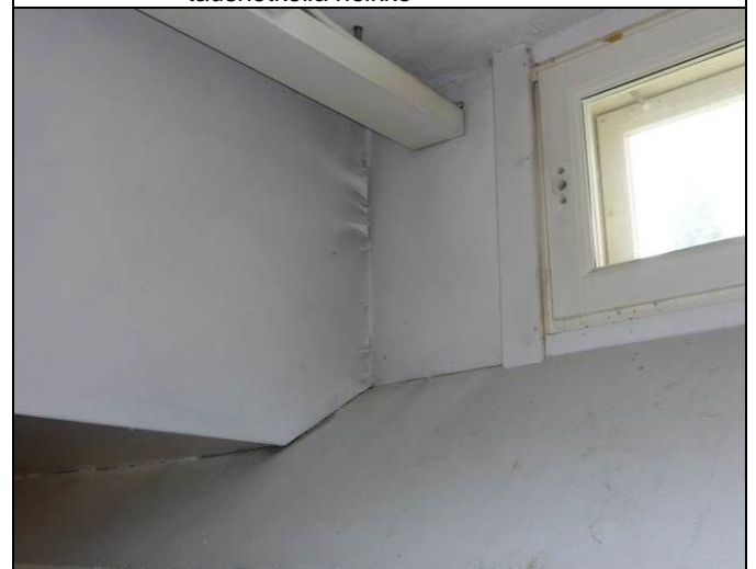
Kuva 44. Tuloilman pääkanavan läpiviennissä on ilmapuotoja. Sisäilman voimakas alipaine on syytä ilmapuotoihin. Mahdollisesti myös sadevesi pääsee raoista kellaritiloihin (kts. kuva 31)
