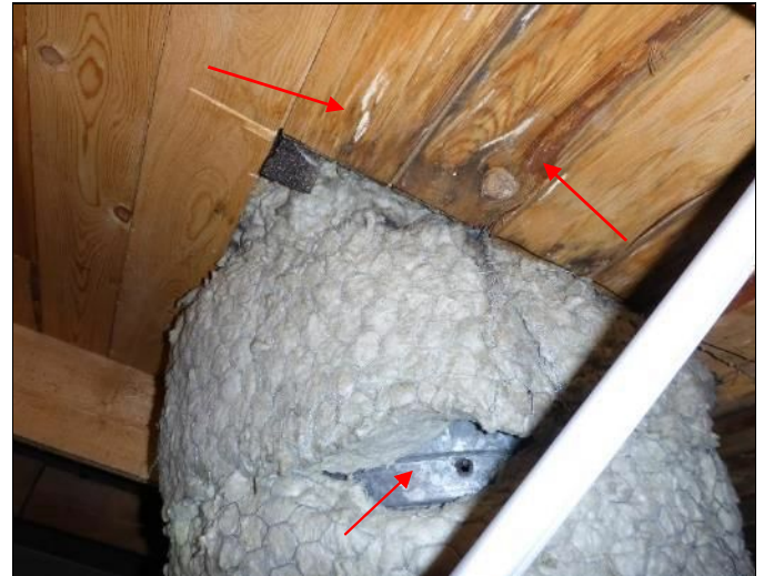
Kuva 27. IV-putken läpiviennin ympärillä on vuotojälkiä. Läpivienti ei ole tiivis, joten vesivuodot ovat mahdollisia myös tulevaisuudessa. Lisäksi putken eristys on puutteellinen
