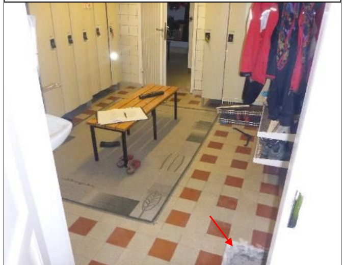
Kuva 13. Tilassa 004 on havaittu vaatteiden kostuvan ja paha haju tarttuu vaatteisiin. Syynä on todennäköisesti viereisen wc- ja suihkutilan lattiasta todettu korkea kosteus ja haju lattiämattom alla. Alapohjan rakenneavaus AP3.
