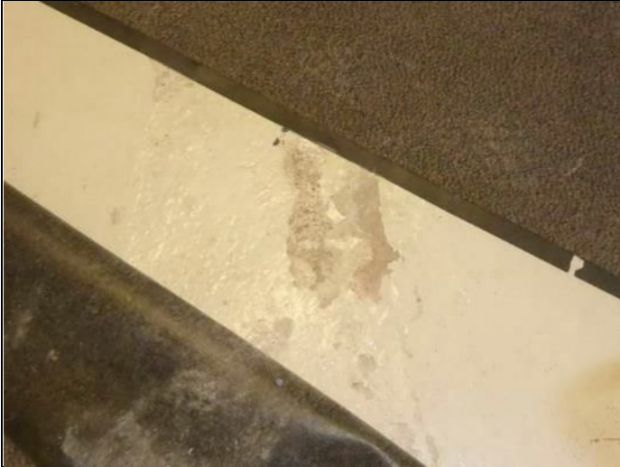
Kuva 10. Porrashuoneessa viemäriputken kohdalla havaittiin maalipinnon kosteusvaurio ja kohonnut kosteus. Lattian vedeneriste on rikottu lattian avauksen yhteydessä. Paikkavaluun ei ole tehty vedeneristystä ja maaperän kosteus nousee pinnon alle.
