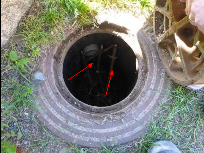
Kuva 7. Sadevesikaivossa on roskaa. Kaivon pohjalla ei ollut vettä, eikä sadevesijärjestelmän toimivuudesta ole varmuutta.
