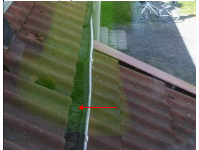
Kuva 37. Sadevesikouruun on kertynyt roskaa. Toimivuuden varmistamiseksi kouru tulisi puhdistaa.
