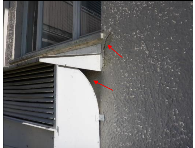
Kuva 23. Ilmanvaihtokanavaan pellitys ei suojaa läpivientiä viistosateelta. Seinärappaus on vaurioitunut ikkunapenkin viereltä.
