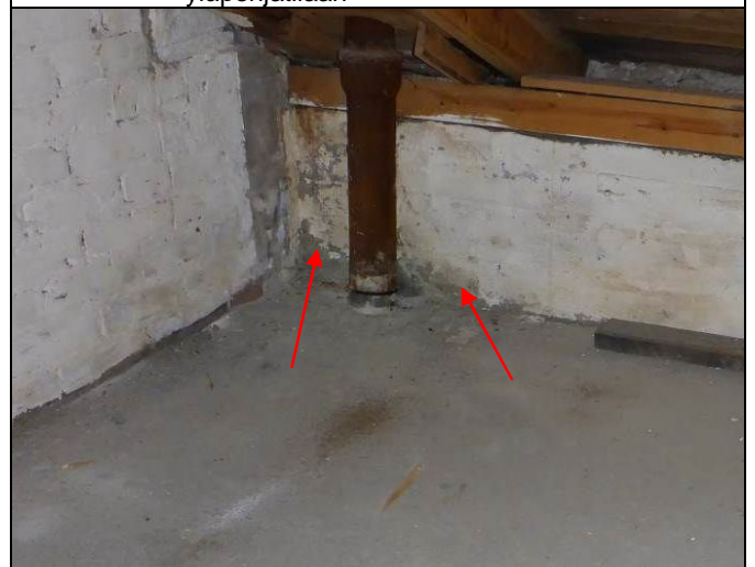
Kuva 33. Putken läpiviennin ympärillä on merkkejä kosteudesta. Vuoto on tapahtunut joko vesikatteen läpiviennistä tai putkesta.
