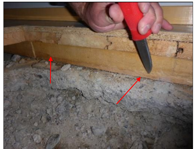
Kuva 9. Tilan 030 lattian rakenneavaus (AP 2). Muovimatolla päällystetty koolattu puulattia on rakennettu maanvaraisen betonilaatan päälle. Koolauspuun alapinnassa on kosteuden aiheuttamia jälkiä.
