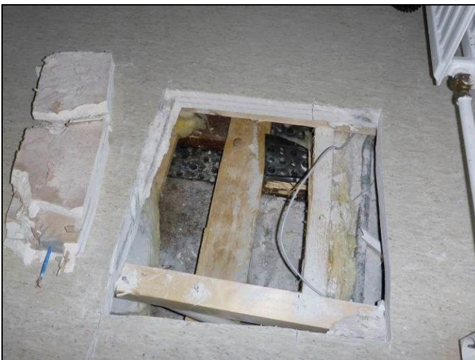
Kuva 8. Tilan 011 lattian rakenneavaus (AP 1). Koolattu lattia on tehty maanvaraisen betonilaatan päälle. Alimpien koolauspuiden pinnassa havaittiin homeista kasvustoa ja tunkkainen haju, lisäksi koolauspuiden painokosteus on koholla. Mikrobianalyysin perusteella (näyte M3) rakenteessa on mikrobivaurio.
