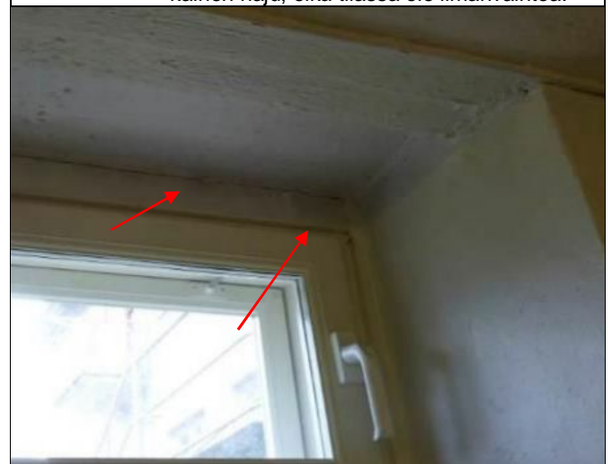
Kuva 17. Ikkunakarmin yläreunassa on ilmavuodon aiheuttamaa tummentumaa. Alipaineen aiheuttama ilmavirtaus voi tuoda sisäilmaan epäpuhtauksia rakenteista.
