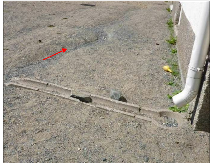
Kuva 2. Sadevedet virtaavat hallitsemattomasti pihalueella. Sorapintaan on muodostunut veden kulkureitti.
