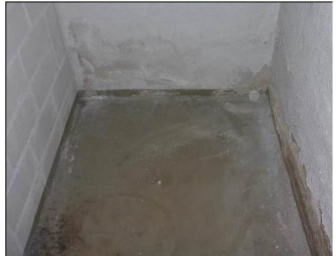
Kuva 15. Maaperän kosteus on noussut porrashuoneen seinille ja aiheuttanut vaurioita pintarappaukseen. Tilassa on kostea ilma ja tunkkainen haju, eikä tilassa ole ilmanvaihtoa.
