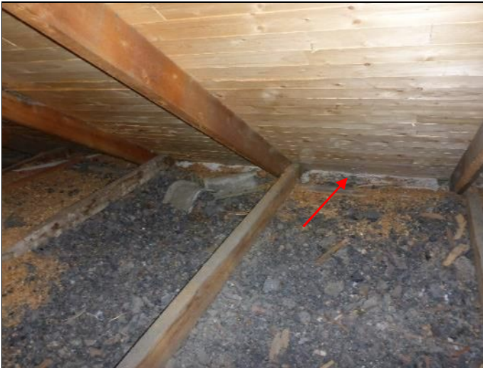
Kuva 28. Yläpohjan tuuletus ei toimi räystäällä. Tuuletusrako on ummessa
