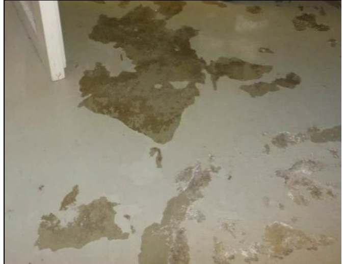
Kuva 11. Kellarin huoltotilojen lattiat ovat maalattuja maanvaraisia betonilaattoja. Maalipinta on monin paikoin irtoillut todennäköisesti maaperästä nousseen kosteuden vuoksi.
