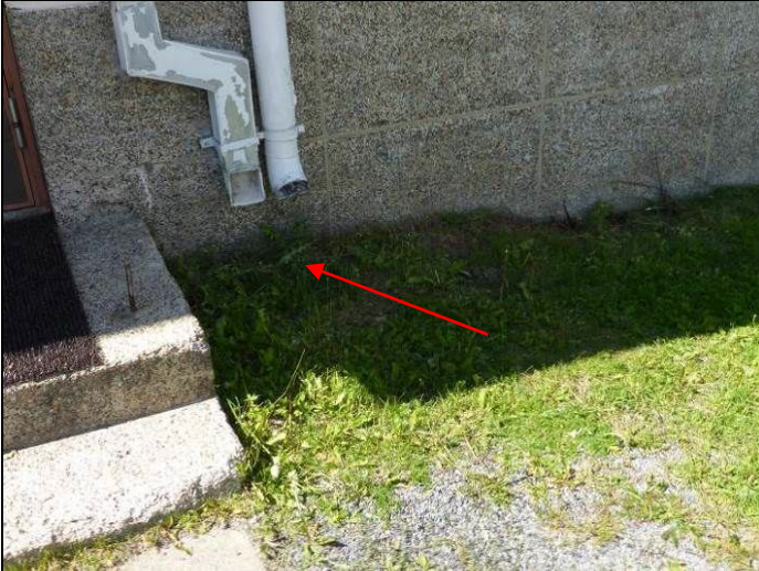
Kuva 5. Syöksytorven alla ei ole sadevesikaivoa tai vesikourua ja pintamaiden kallistukset ovat puutteelliset. Pintavedet aiheuttavat ylimääräistä kosteusrasitusta seinärakenteeseen ja talon vierustalle.
