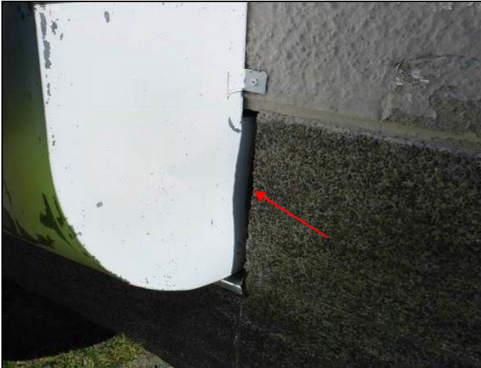
Kuva 22. Ilmanvaihtokanavan läpivienti on avoin. Sadeves pääsee raosta kastelemaan seinärakenteita.
