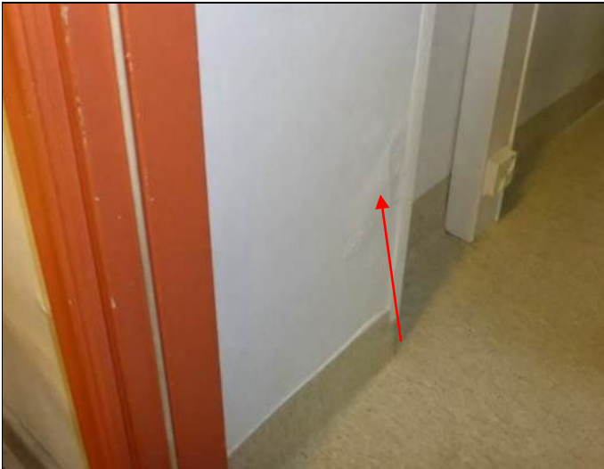
Kuva 18. Seinän maalipinta kupruilee rakennekosteuden seurauksena. Kosteus nousee seinälle todennäköisesti rakenteita pitkin alapohjasta.
