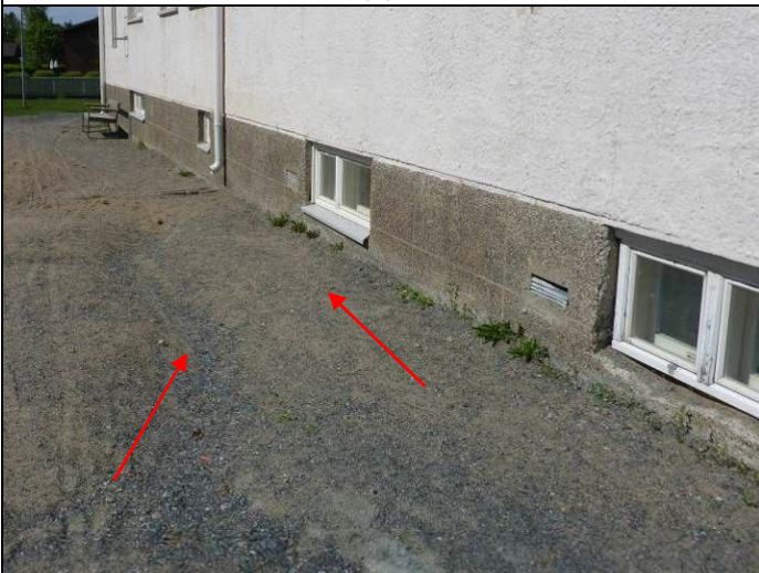
Kuva 3. Pintamaiden kallistukset ovat puutteelliset. Pintavedet aiheuttavat ylimääräistä kosteusrasitusta sokkeliin ja perusmuurin pintaan.
