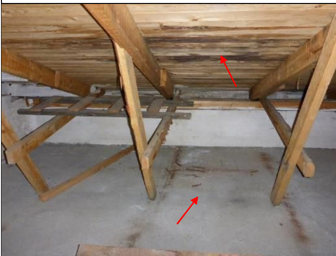
Kuva 32. Uuden osan yläpohjassa ei ole lämmöneristettä. Umpilaudoituksen pinnassa on kosteusvaurio. Tutkimushetkellä pinnat olivat kuivia
