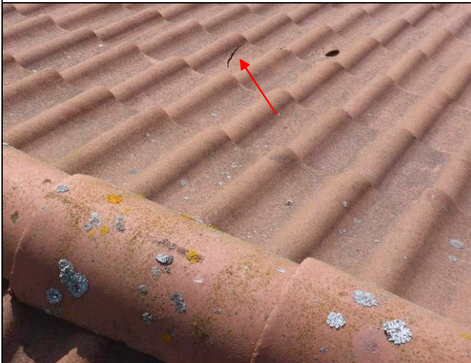
Kuva 36. Tiilikatteessa on haljonneita tiliä. Sadevesi aiheuttaa ylimääräistä kosteusrasitusta aluskatteelle ja voi aiheuttaa kosteusvaurioita yläpohjaan ja kantaviin rakenteisiin
