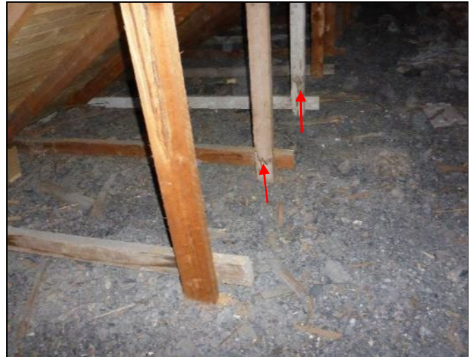
Kuva 29. Vanhan osan kehärstikon pystytuissa on vuotojälkiä. Vuoto on tapahtunut todennäköisestä vesikatteen läpi
