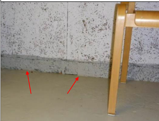
Kuva 16. Tilassa 026 on havaittu voimakas haju, joka voi johtua Tojalevyn vaurioitumisesta. Tojalevyn alapinta on yhteydessä alapohjaan, joka voi päästä vaurioittamaan puumateriaalia.
