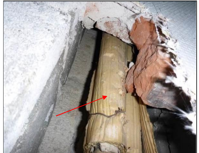
Kuva 19. Tilan 011 perusmuurin rakenneavaus (PM2). Pahvipintaisen putkieristeen sisäpinnalla on asbestipitoinen kangas.
