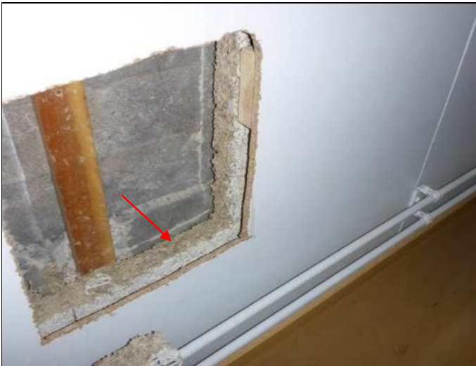
Kuva 14. Tilan 030 perusmuurin rakenneavaus (PM1). Tilassa havaittiin selkeästi voimakas haju, joka voi johtua Tojalevyn vaurioitumisesta.
