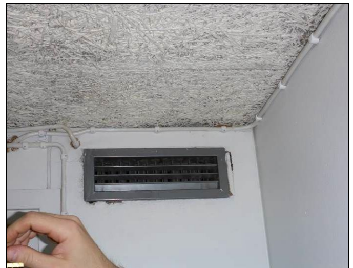
Kuva 42. Tuloilmakanava on nurkassa ja virtaus suuntautuu kattopinnoille. Tuloilmavirtaus oli mitaushetkellä heikko
