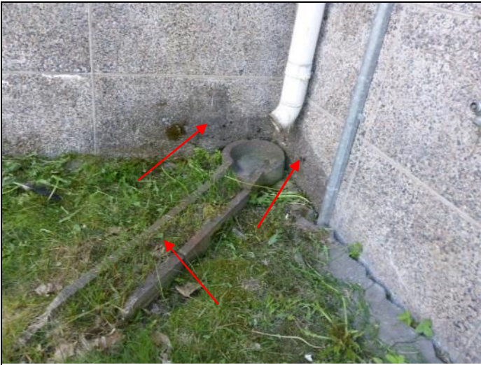
Kuva 1. Ulosheittäjä on väärin suunnattu sekä liian lyhyt, joten roiskevesi on kastellut seinärakenteita. Sammalkasvusto kourussa viittaa siihen, että vesi ei poistu kourua pitkin tehokkaasti ja sadevedet imeytyvät rakennuksen vierustalle.
