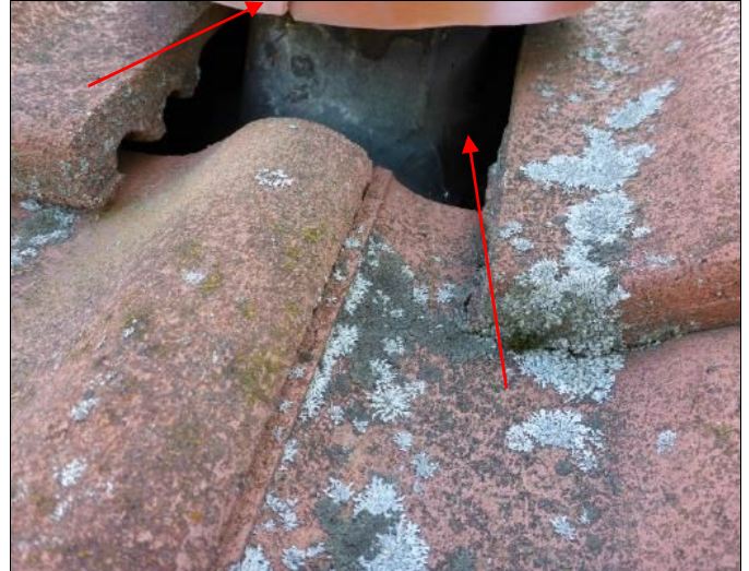
Kuva 39. Läpiviennin pellitys on puutteellinen ja juureen jää iso rako. Vesi pääsee tunkeutumaan katon ja yläpohjan rakenteisiin aiheuttaen kosteusvaurioriskin
