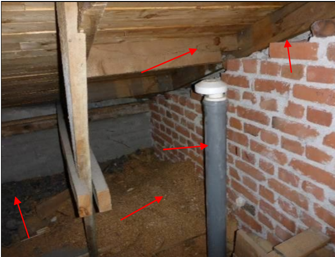
Kuva 26. Vanhan osan yläpohjassa eristeenä on käytetty soraä sekä sahanpurua. Yläpohjan puurakenteissa on vuotojälkiä. Ilmeisesti viemärin tuuletusputki on tuotu yläpohjatilaan
