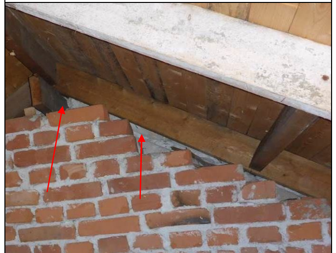
Kuva 31. Vanhan osan yläpohjan tuuletus tapahtuu päädyn tiiliseinän raoista. Raot ovat paikoitellen suuria, joten sadevesi- ja lumi saattavat päästä yläpohjatilaan
