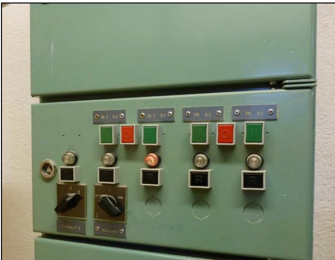
Kuva 41. Rakennuksen ilmanvaihtojärjestelmä on alkuperäinen
