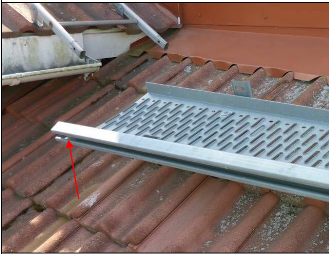
Kuva 40. Kattosillan pään kiinnitys on puutteellinen. Silta on vinossa ja aiheuttaa turvallisuusriskin katon käyttäjille
