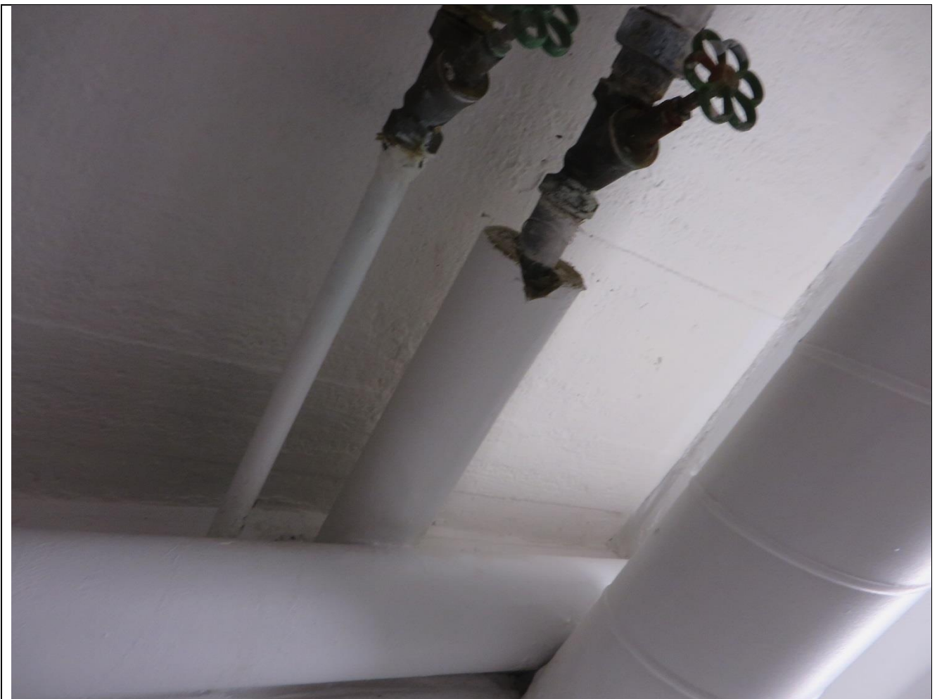
Kuva 3. Kellarin wc:n putkieristeen asbestinäyte.
