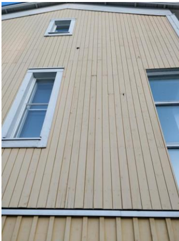
Kuva 16 Eteläpään verhouksessa vaurioita, syy jää epäselväksi. Huollon yhteydessä syytä selvittää ja mahd. korjata
