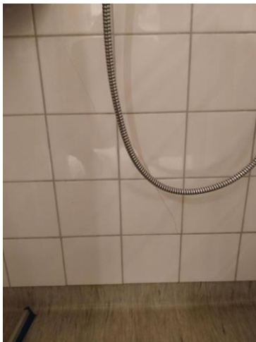
Kuva 28 laattoja halki, pinnoitteet käyttöikänsä päässä
