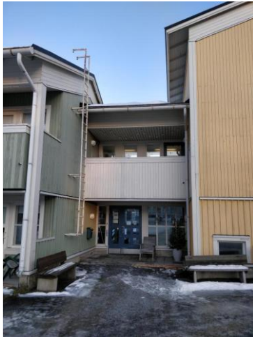
Kuva 3 vesikatolle kulku putoamissuojaamattomia tikkaita pitkin
