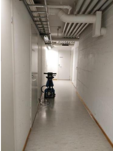
Kuva 26 kellarikäytävää; muovimattopinnoilla kauttaaltaan korkeat pintakosteusarvot
