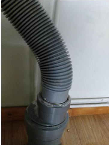
Kuva 4 huoneistossa I13 keittiön altaan viemäri vuotaa; haitariputki haurastunut ja rikki
