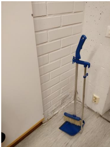
Kuva 5 Kellarissa sosiaalitilan seinä märkä ja maalit kupruilee
