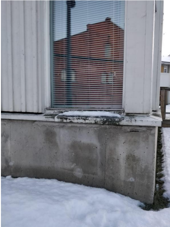
Kuva 34 Ruokasalin ikkunoiden alalaidassa sekä ikkunapellityksissä kasvaa sammalta
