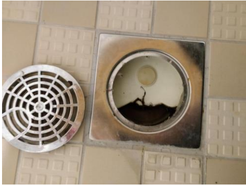
Kuva 37 lattiakaivot muovisia, ei puutteita todettu
