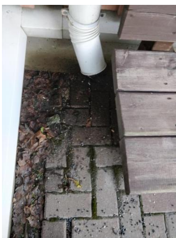
Kuva 10 kattovedet jäävät rakennuksen seinustoille
