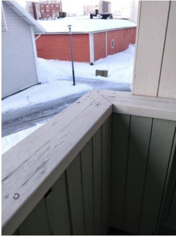
Kuva 19 Myös parvekekaiteiden vaakalaudoituksissa lahoa
