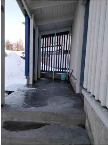
Kuva 2 keittiön oven edustalle kerääntyy tasanteelle jäätä
