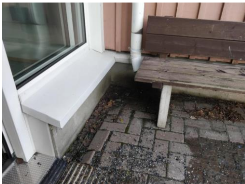
Kuva 8 paikoin maan pinta kallistuu kohti rakennusta
