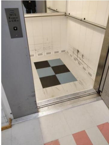
Kuva 35 Hissin pinnoitteet kaipaavat siistimistä. Hissi on pienehkö kiinteistön käyttötapa huomioiden
