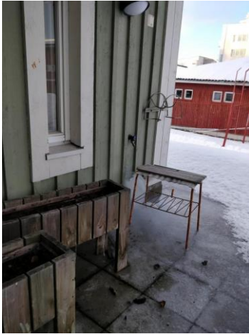
Kuva 6 ulkovesiposti vuotaa oleskelupihalle.
