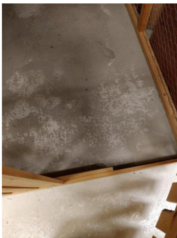
Kuva 29 varaston lattiasta maali hilseilee
