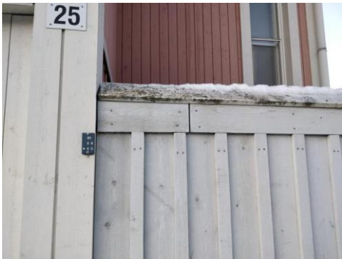
Kuva 18 Kaidarakenteet huollon ja osin uusimisen tarpeella, katelaudat lahoja
