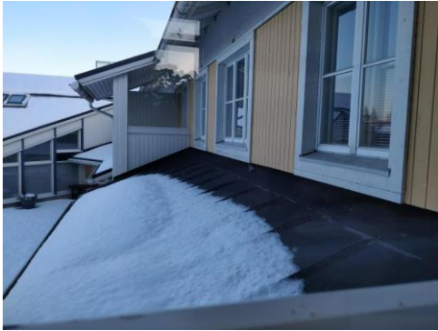
Kuva 15 Lautaverhoukset pääosin siistit
