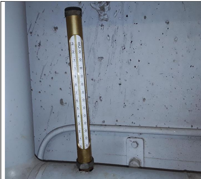
Lämmönjakohuoneessa elohopea mittareita, pari kappaletta
